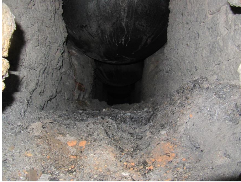
Figura 21. Ducto cámara de combustión
