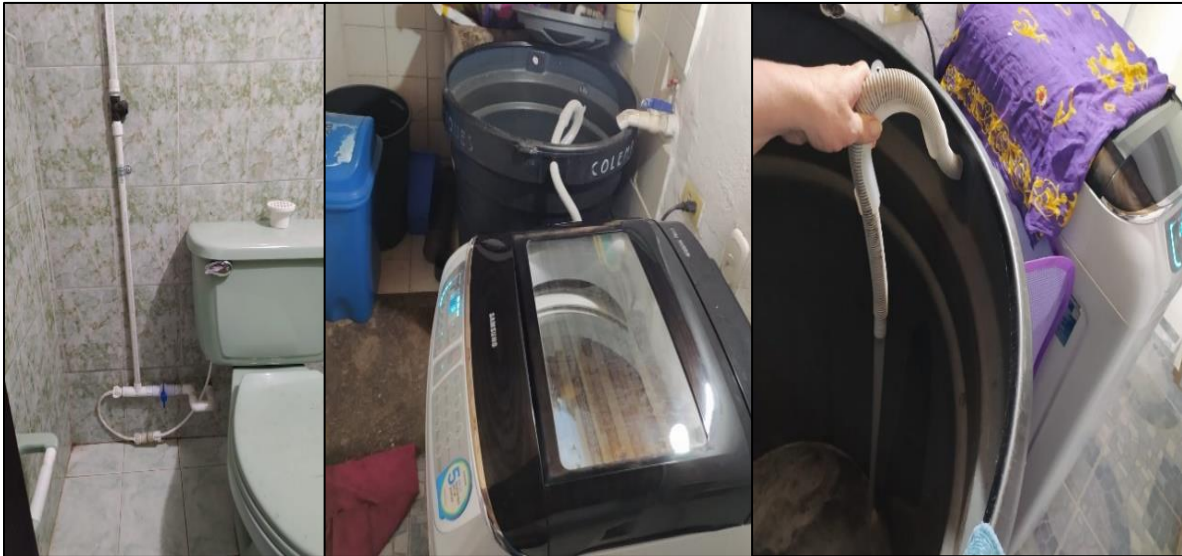
Ilustración 21 Sistema De Aprovechamiento Vivienda N°2
