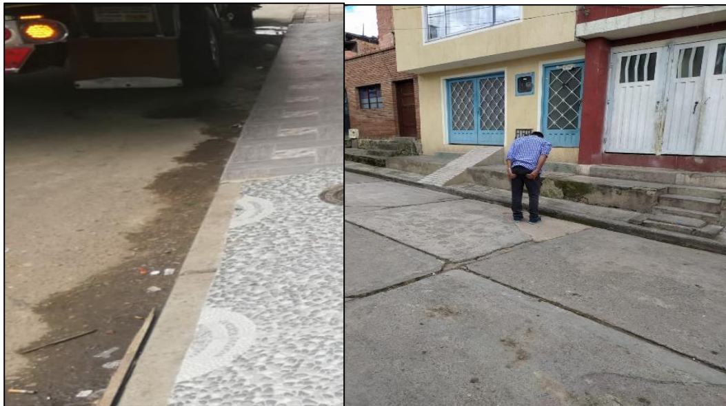
Ilustración 16 Evidencias de Daño de Tubo y Conexiones Erradas
