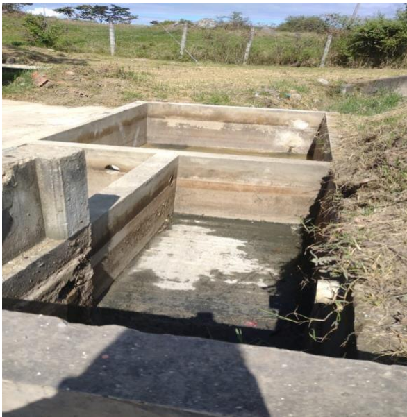
Imagen 4. Caja de Recepción de aguas.
