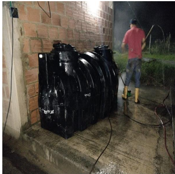
Imagen 5 Tanque de recolección lixiviados.
